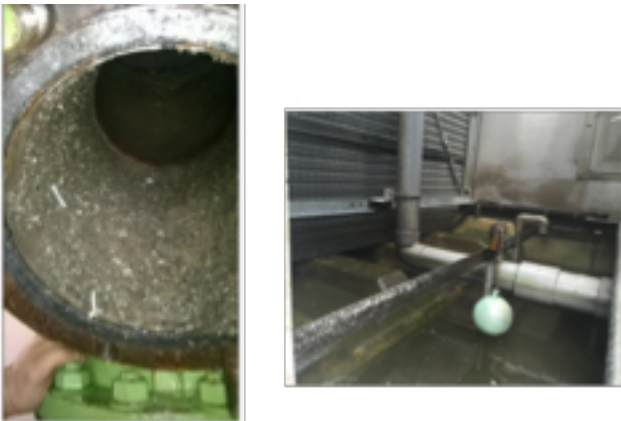
Abbildung 2: Bildung eines Biofilms in den Rohren und dem Behälter des Kühlturms
